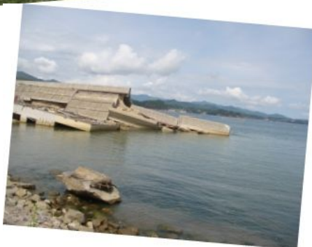
破壊された防潮堤
