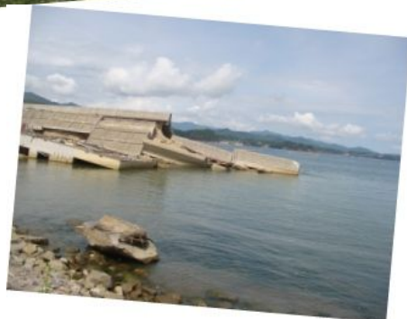
破壊された防潮堤
